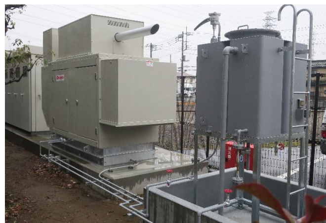
発電機（BCP対応）
