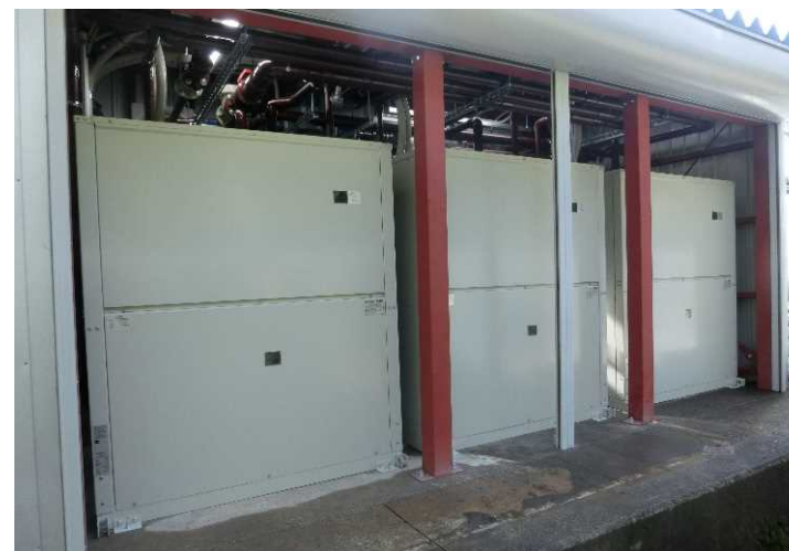
熱回収ヒートポンプチラー
