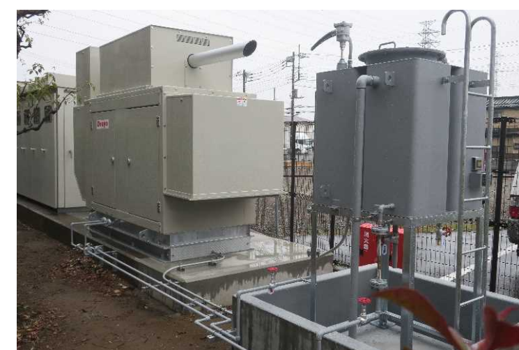
発電機（BCP対応）
