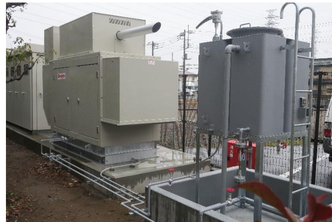
発電機（BCP対応）
