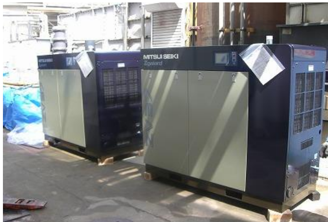
コンプレッサー
