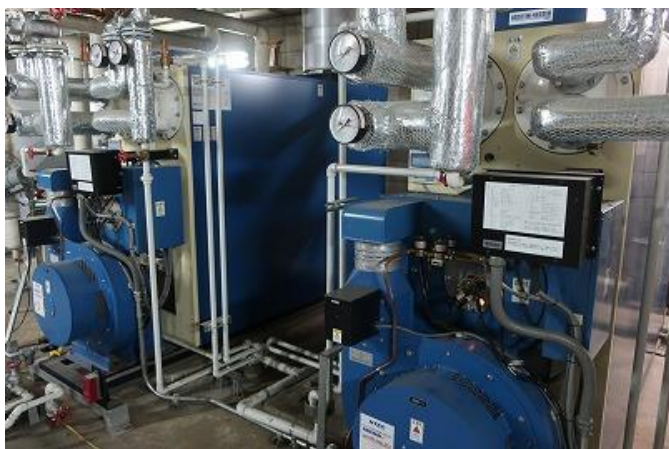
ボイラ・ガス給湯器・コジェネ
