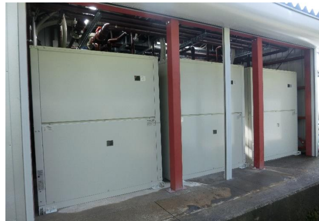
熱回収ヒートポンプチラー
