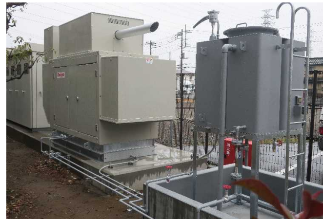
発電機（BCP対応）
