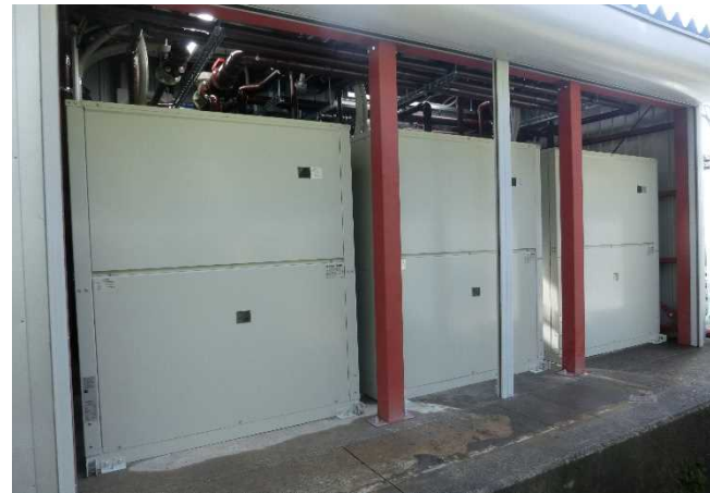
熱回収ヒートポンプチラー
